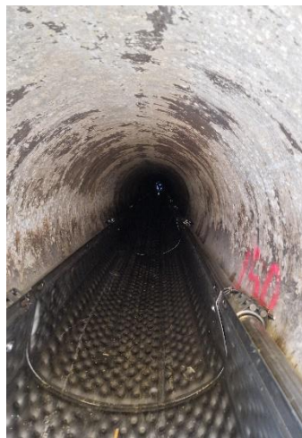
Abbildung 2: Abwasserwärmetauscher Gemeinde Dußlingen
